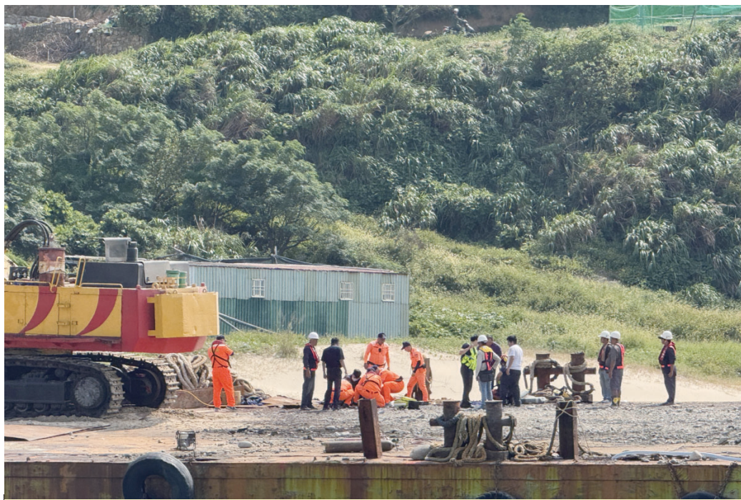
東莒猛澳港昨（15）日上午發生重大工安意外，3名作業員在浮動平台船艙內作業時發生事故。（圖／文：蔡夢玲）
